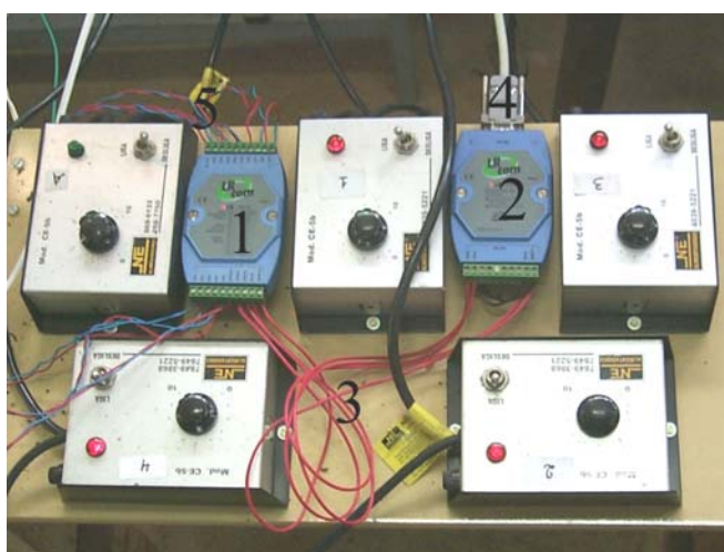
Figura A.1 – Módulos de aquisição de dados e diais de controle dos vibradores. 1: módulo LR-7018; 2: módulo LR-7520; 3: fio RS-485; 4: cabo RS-232; 5: fios dos termopares (vermelho (-) e azul (+)).
