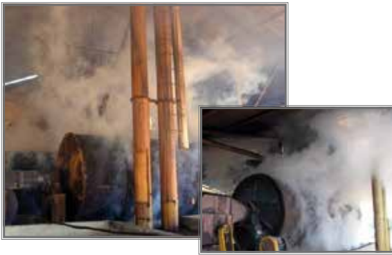
Figura 4. Tipo de secagem com temperaturas altíssimas e a falta de controle ambiental.
