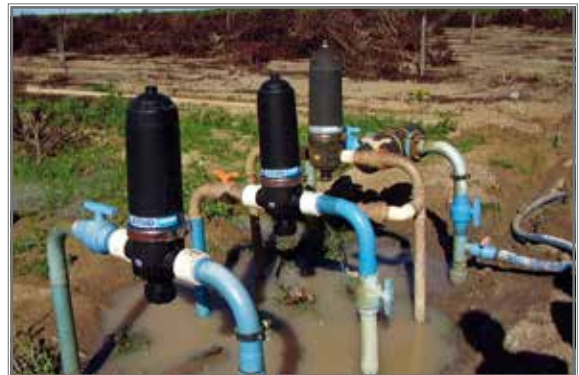
Figura 9. Componentes da estação de controle de um sistema de irrigação localizada.
