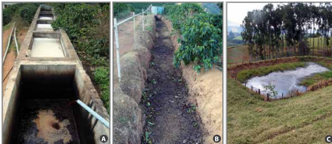
Figura 11. Tanque de decantação (A); vala de infiltração (B); e lagoa de infiltração (C).
