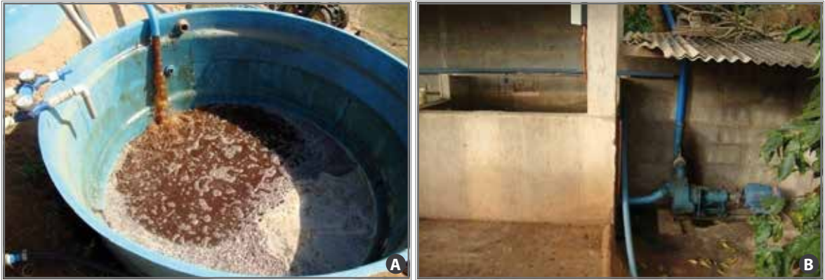
Figura 7. Caixa de reúso da água residuária (A); bombeamento da caixa de decantação para reúso (B).
