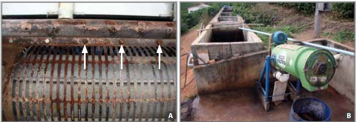
Figura 8. Esguicho com furos entupidos (A); filtro de resíduos sólidos (B).
