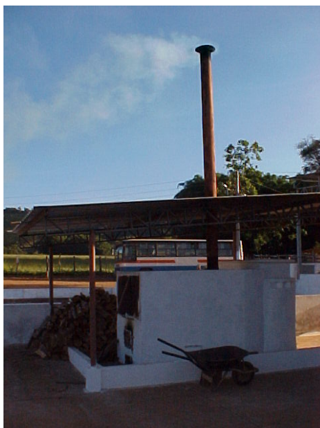
Figura 6 – Vista lateral da fornalha a fogo indireto com lenha dos terreiros secadores.
