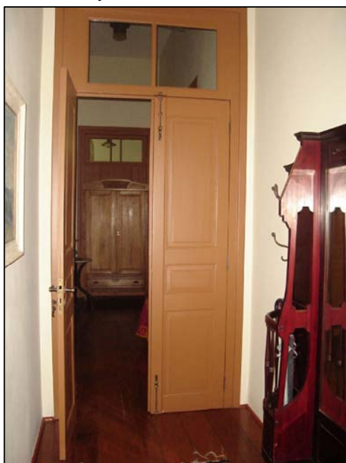
Porta de fechamento do hall de entrada.
