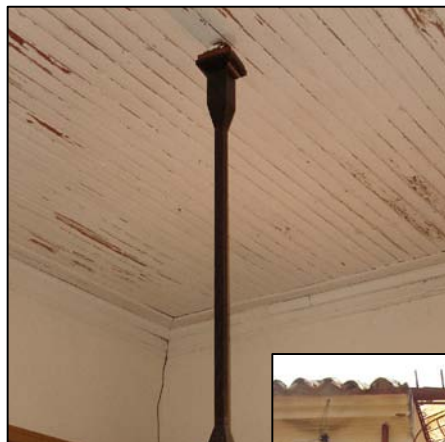
Detalhe do forro e de reachadura em parede da sala de estar.
