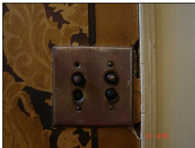
Interruptor do hall de entrada, com a parede danificada entre ele e o batente da porta.
