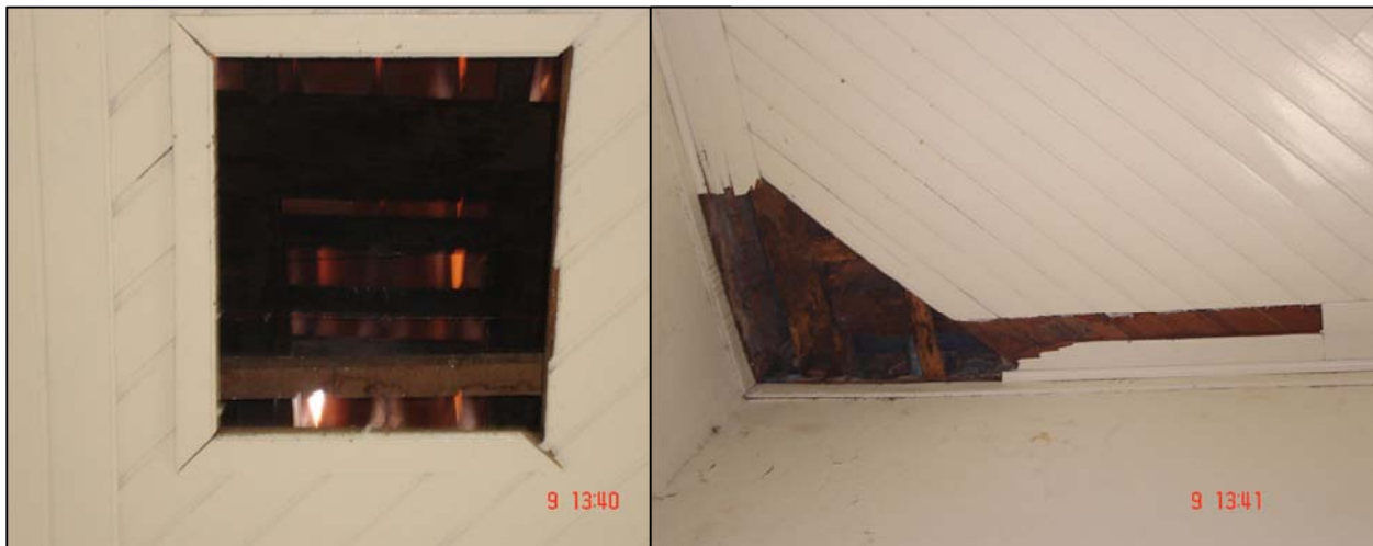
Aberturas no forro, em virtude de má conservação.
