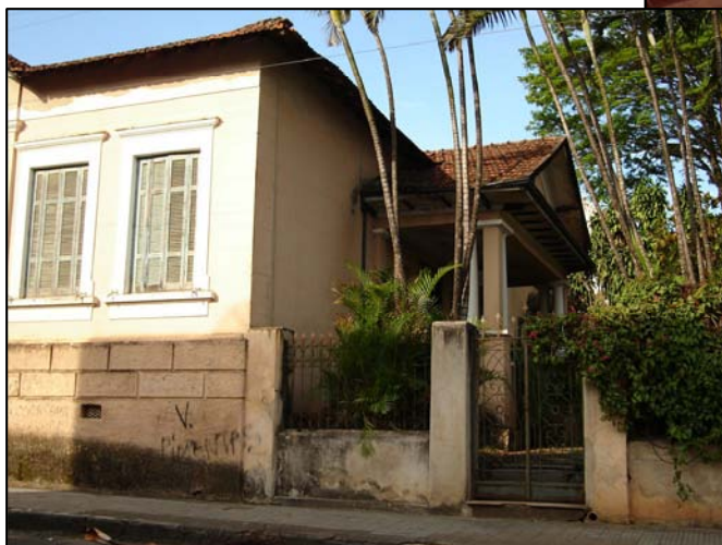
Fachada antes da reforma, com manchas de umidade no embasamento.
