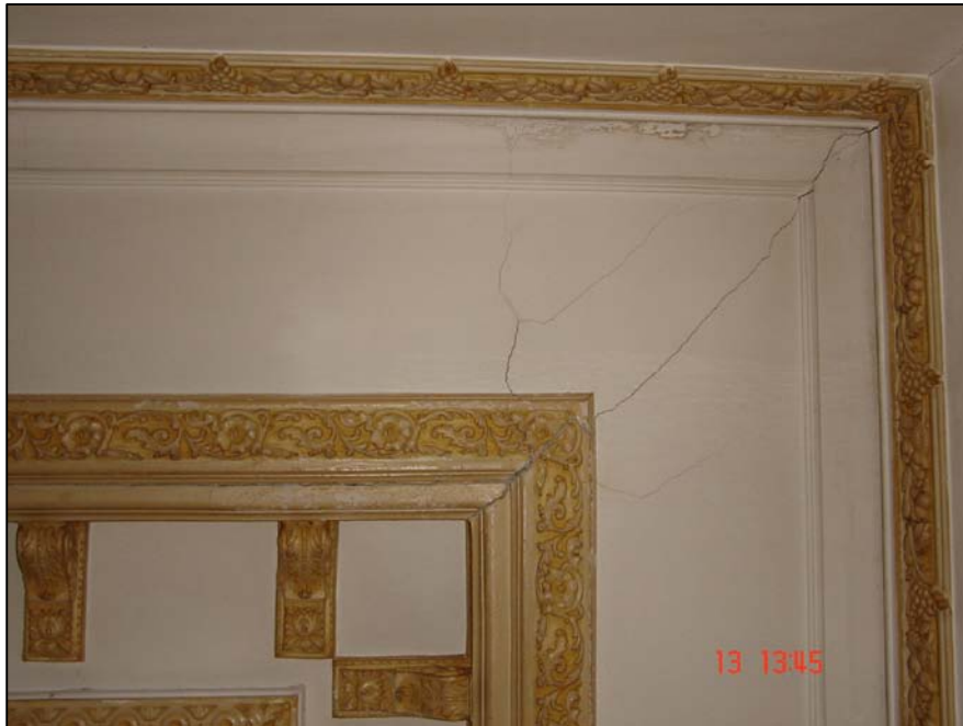
Marcas de rachaduras no teto da sala de jantar.
