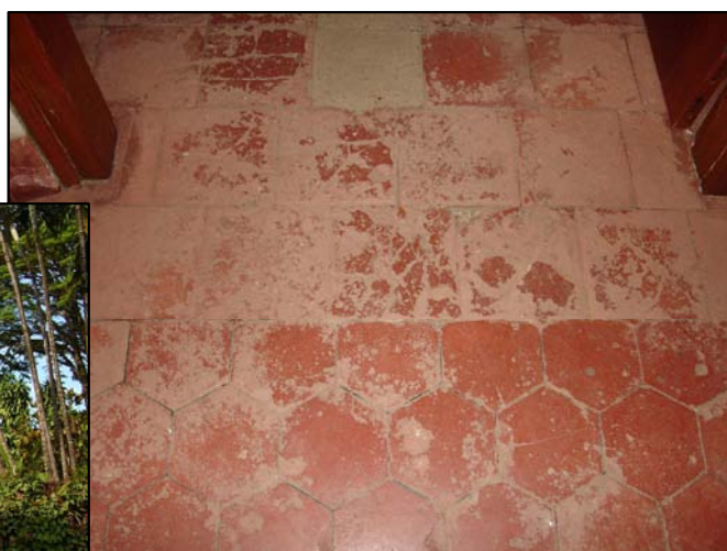
Piso da copa e cozinha, bastante danificado na época do levantamento.
