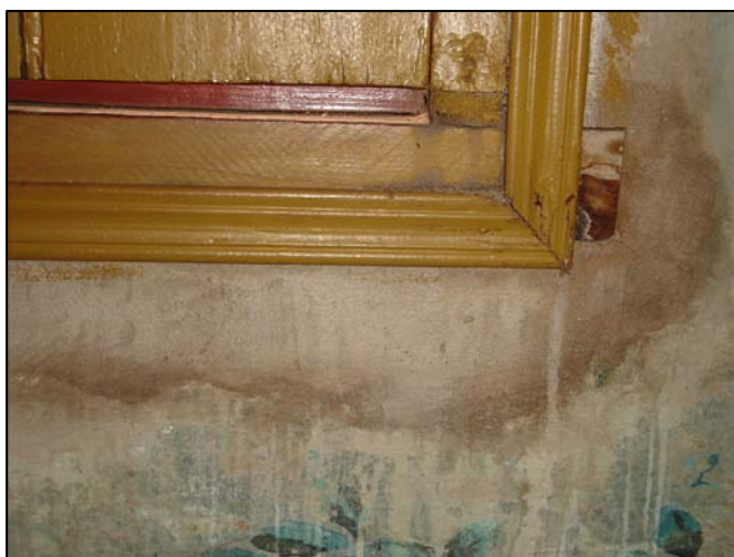
Paredes de dormitórios, danificadas.
